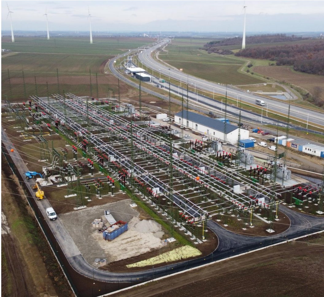
Umspannwerk Kettlasbrunn Süd März 2024
